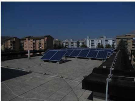
Itis Avezzano. Intervento attività 1.1 realizzato da Provincia dell'Aquila. Impianto fotovoltaico
